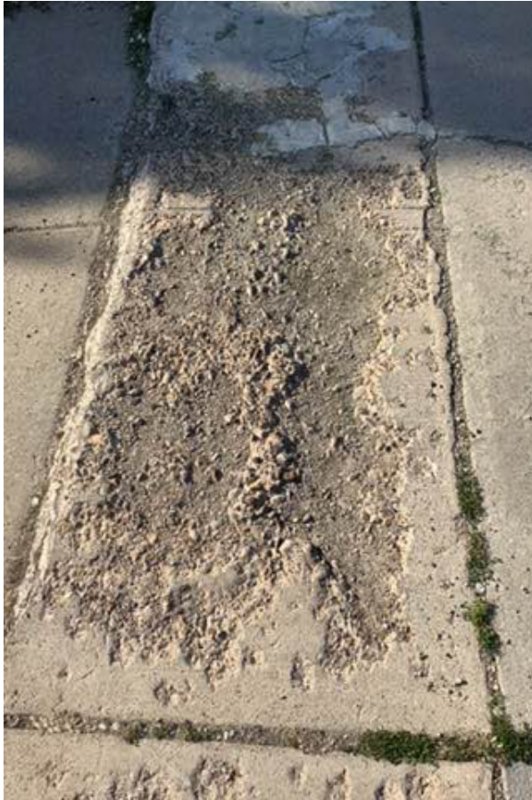
#30 491 N 400 E Spalling
